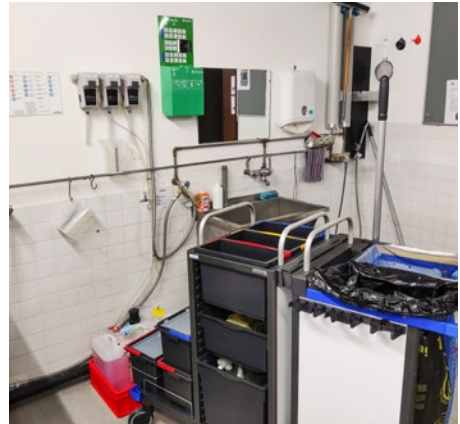
Das neue Dosiersystem.
